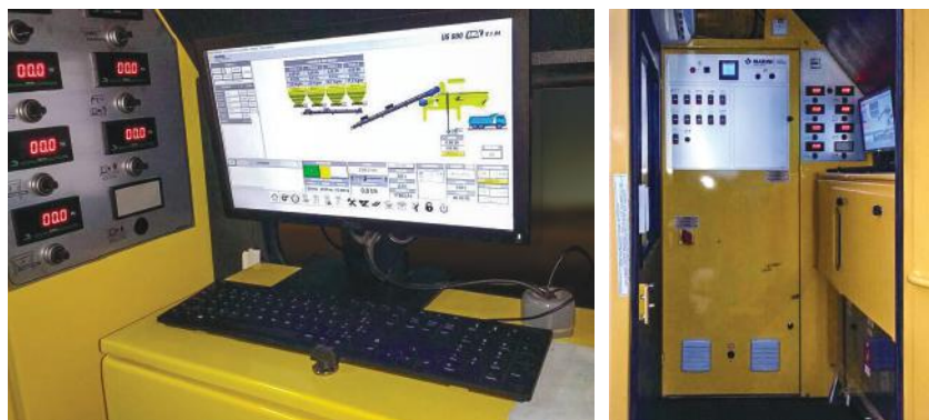
Cabina de mando climatizada con sistema de control automático y manual.
